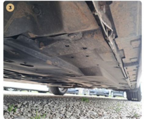
✓ Utascella és gyűrődő zónák Az autó alján említésre méltó korrózió nem látható
