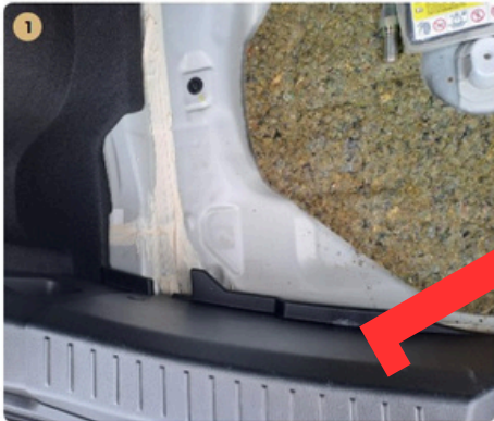
1 Utascella és gyűrődő zónák A csomagtartó alatti fenéklemezen javításra utaló nyomok nem találhatók.
