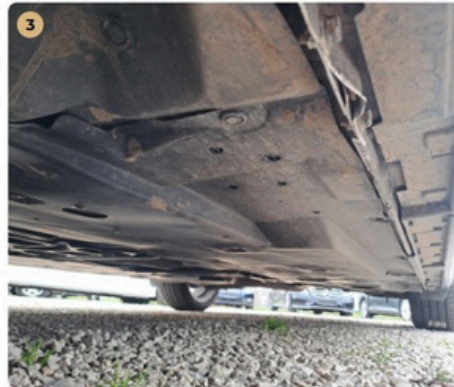
3 Utascella és gyűrődő zónák Az autó alján említésre méltó korrózió nem látható.
